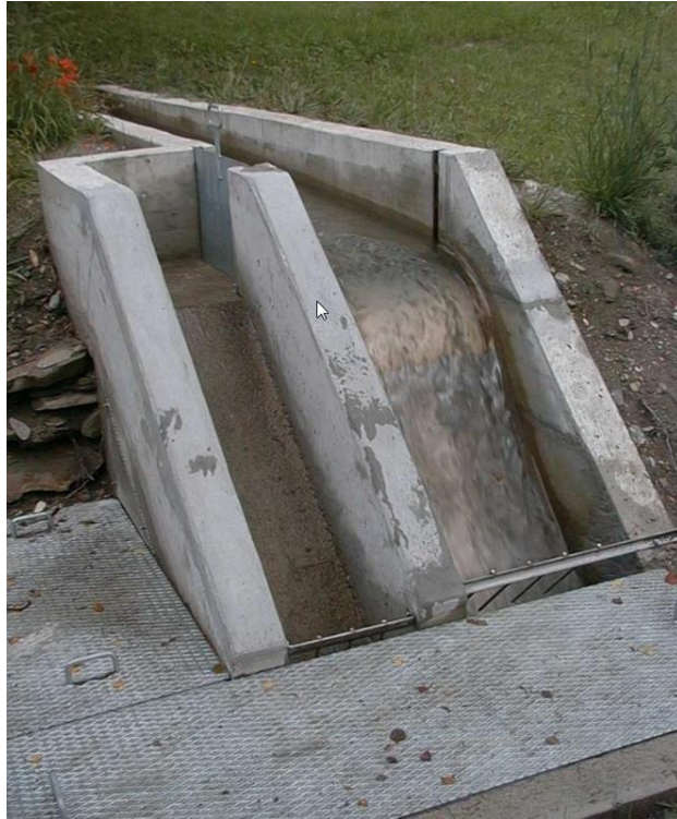
Photo: Coandarechen/ prise Conada, Bewässerungsanlage – installation d'irrigation Ried-Brig
