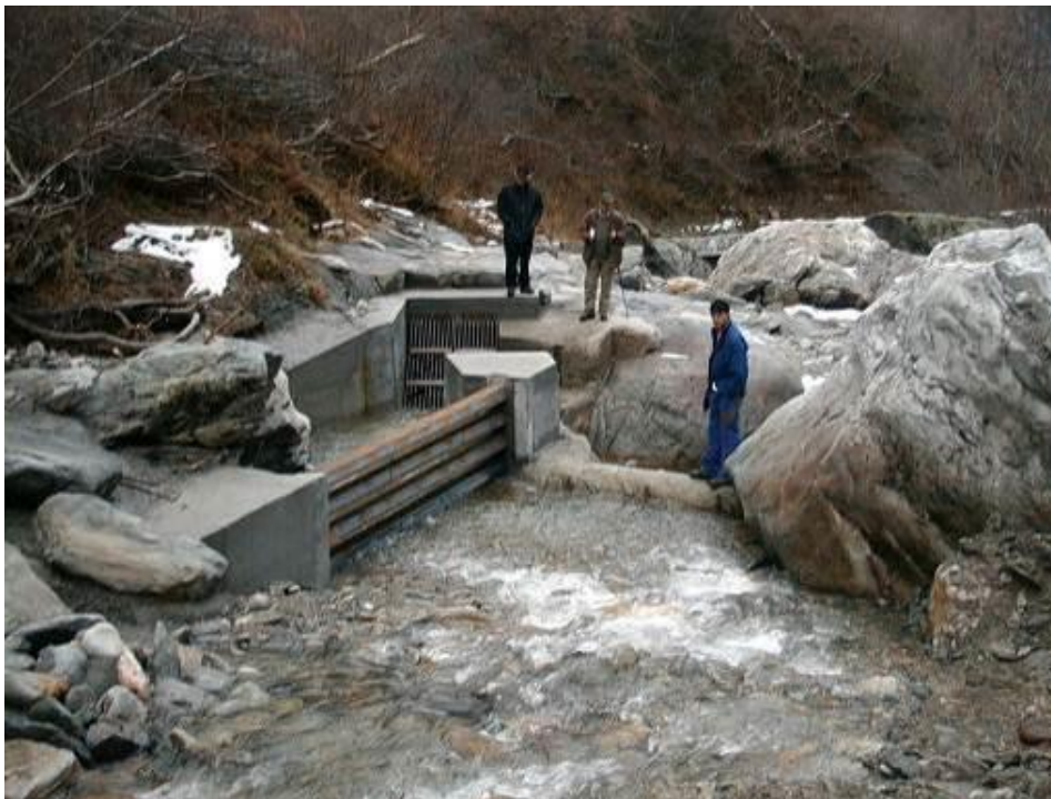
Seitliche Entnahme aus dem Bachbett mit Querrechen/Tirolerwehr prise latérale avec protection/prise tyrolienne Photo: Gorperi - Baltschiedertal
