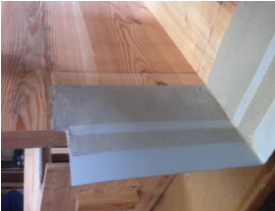
Photo: Holzkanal aus Lerchenholz mit Abdichtungsband Canal en mélèze avec joint d'étanchéité (Büro SILVAPLUS, Martigny)
