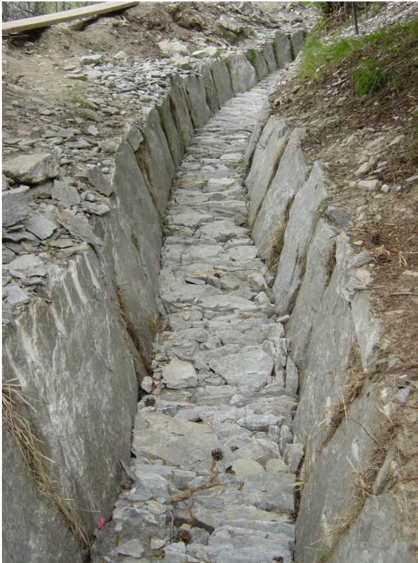
Photo: Bentonitmatte mit seitlichen Stellplatten und einer Sohlenbikki überdeckt / Abdichtung der WL infolge eines darunterliegenden Quellschutzgebietes / Natte de bentonite avec des berges par des dalles irrégulières et consolidation du lit avec des pierres (Sohlenbikki) étanchéité du bisse nécessaire à cause d'une zone de protection de source en aval Gorperi - Eggerberg
