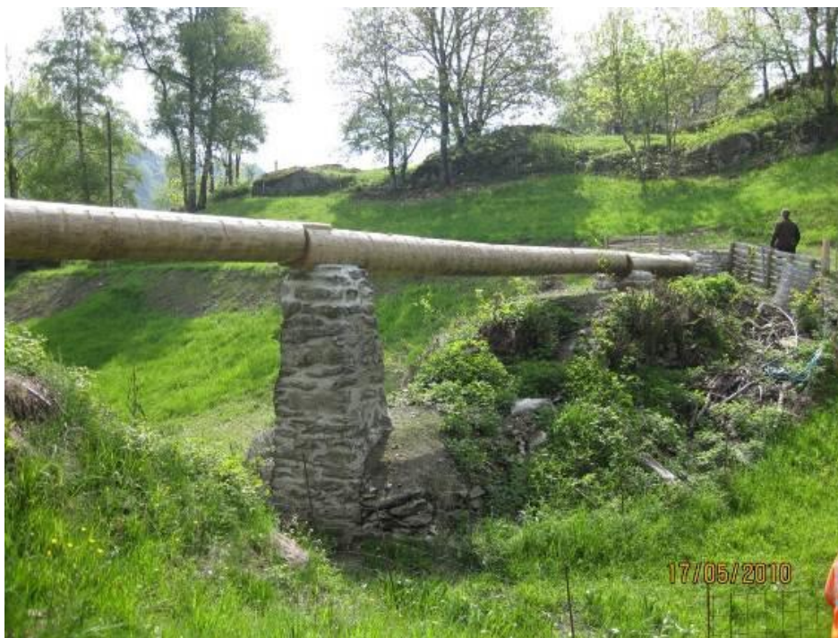
Photo: Holzkännel auf gemauertem Steinsockel / bazot posé sur des socles en pierre maçonnées Untere Bitscheri - Naters
