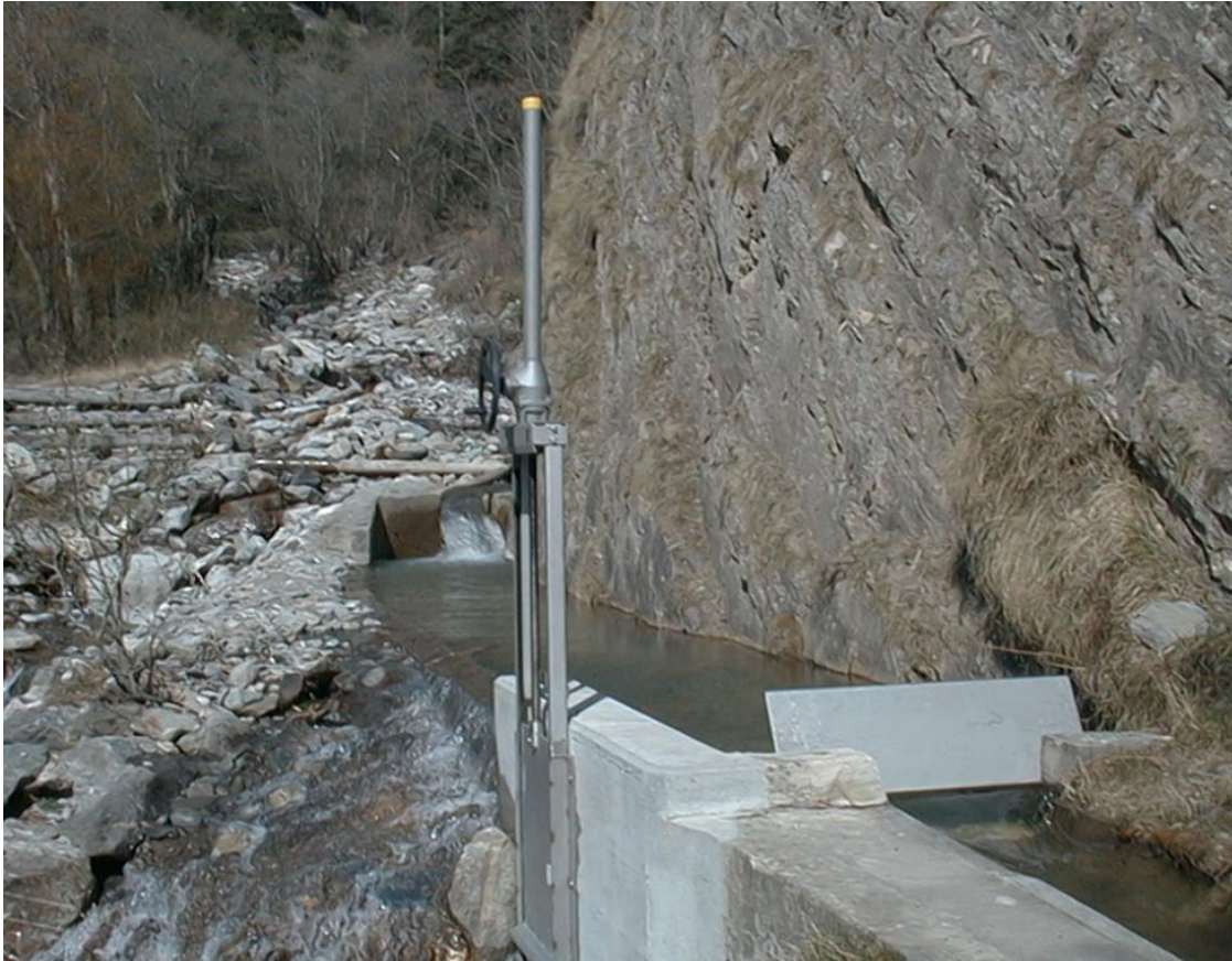
Seitliche Entnahme aus dem Bachbett mittels einer Schwelle / prise latérale avec seuil Photo: Ladusun -Niedergesteln
