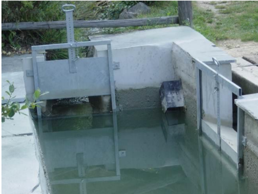
Photo: Verteilschacht mit Mengenbegrenzung / chambre de répartition avec limiteurs de débit Gorperi - Eggerberg
