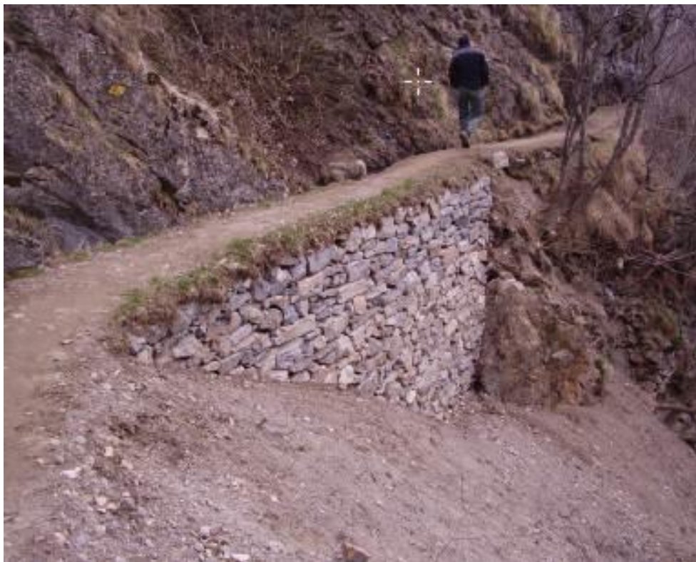
Photo: Trockenmauer vor einer WL / bisse à l'arrière d'un mur de soutènement en pierres sèches Manera - Raron (Foto F. Pfammatter)
