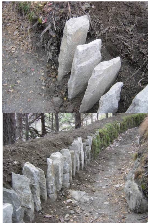
Foto: Bau einseitiges Tretschbord; Consolidation des berges du bisse avec des pierres d'un côté / Visperi - Visp
