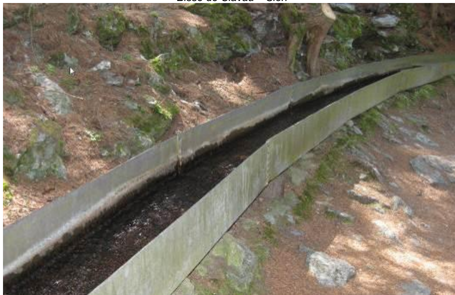
Photo: Galvanisierter Blechkanal / chenal en acier galvanisé Bisse de Vercorin – Chalais
