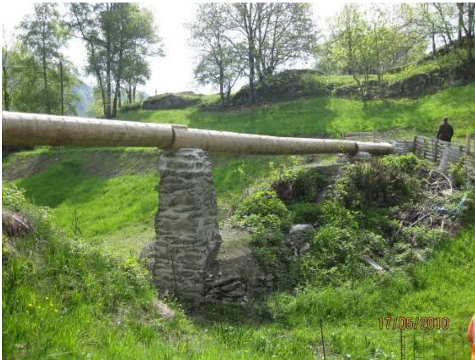
Photo: Holzkännel auf gemauertem Steinsockel / bazot posé sur des socles en pierre maçonnées Untere Bitscheri - Naters
