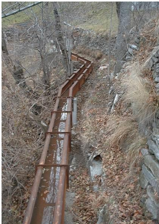
Photo: unbehandelter Stahlkanal / chenal en acier non traité Tenneri – Eggerberg
