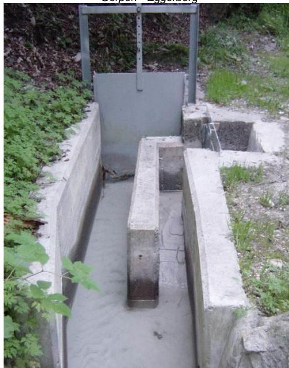
Photo: Wasserverteilschacht (Verteilung der Wassermenge 1/3 und 2/3) chambre de répartition (1/3 et 2/3) Gorperi - Eggerberg
