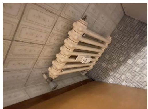
Radiateur avec vanne
