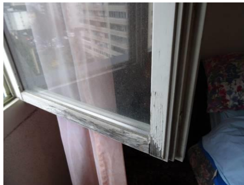
Encadrement de fenêtre endommagé (chambre)
