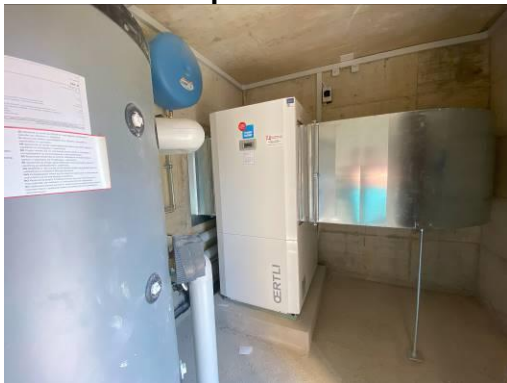
Pompe à chaleur
