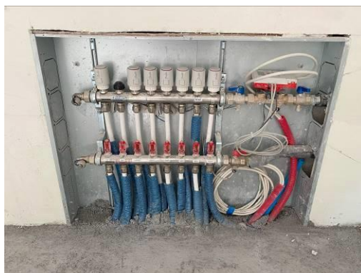
Chauffage au sol
