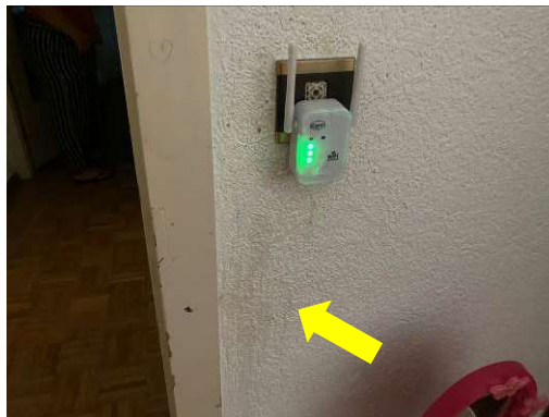
Rafrâichissements de peinture à prévoir
