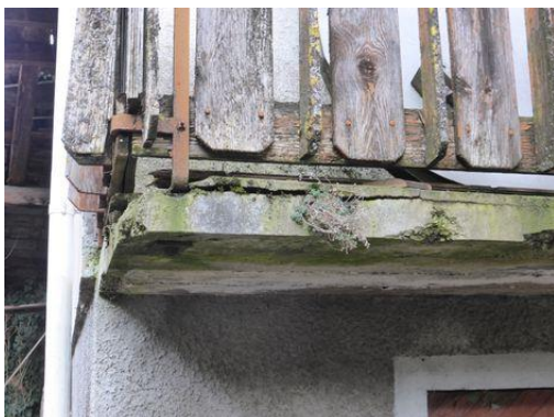
Dalle balcon fissures
