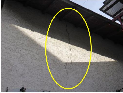
Fissure murale | Façade Ouest
