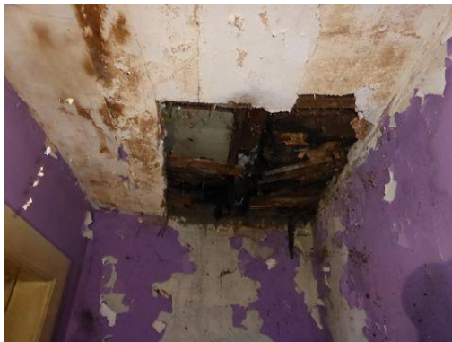
Affaissement plafond combles
