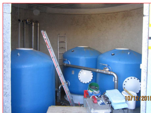
Installation d'élimination de l'uranium et de l'arsenic contenus dans l'eau potable
