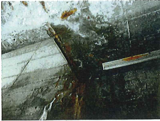
Problème de carbonatation (escalier -2)
