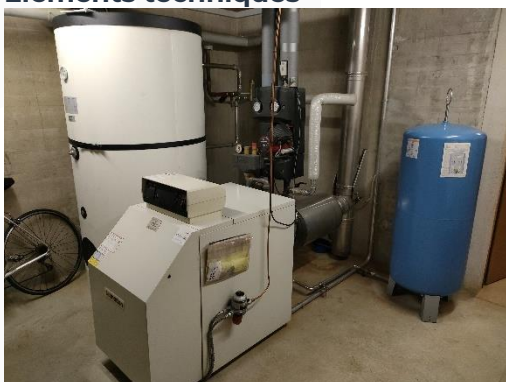
Chaudière à mazout | Boiler | Vase d'expansion
