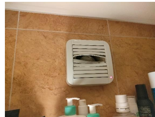
Ventilation mécanique ! Défectueuse
