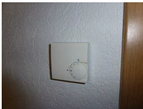
Thermostat | chauffage au sol
