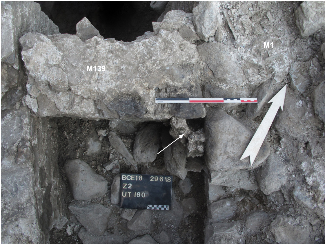
Fig. 23. Bagnes. Villette. Zone 2. Mortaise pour le tenon d'un porte ou d'un petit portail dans l'angle entre le seuil maçonné M139 et l'ancien mur de clôture M1 alors arrasé. Vue vers le nord-ouest.
