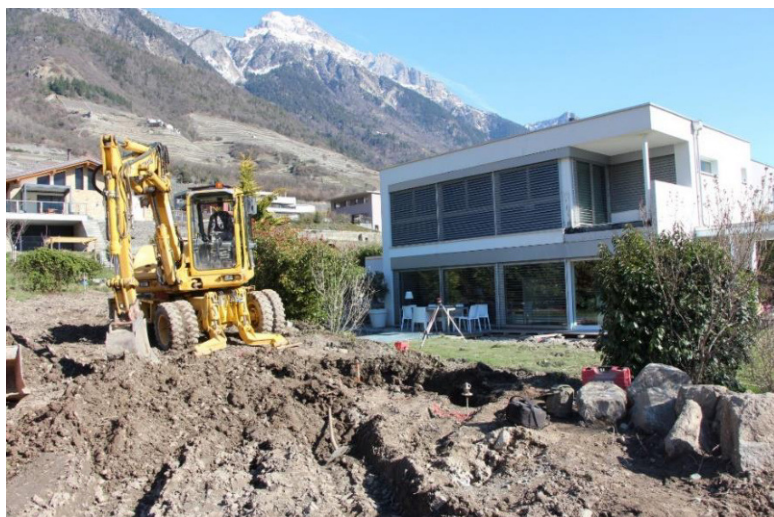
Fig. 1. Vue générale de l'intervention, le 16 mars 2020. Vue vers le nord. Photo OCA
