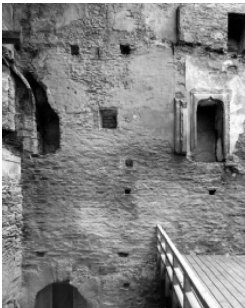
Abb.55 Palasannex, Südwand. Unten angeschnitten die Kellertüre des Palas: Am rechten Bildrand die Türen, die vom jüngeren Treppenturm aus in den Palas führten. Die Stufen waren seitlich in die Mauer verankert. Am linken Bildrand die Einfeuerungsöffnung eines Stubenofens. Dazwischen eine in die Mauer eingebrochene Durchreiche.
