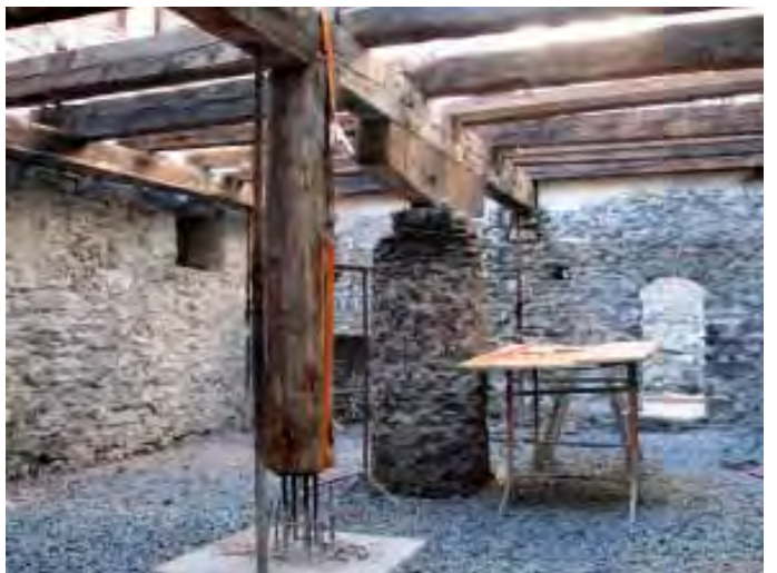
Abb.24 Palas, Keller, Aufnahme während der Sanierungsarbeiten von 2006. Der Boden wurde isoliert und die Deckenkonstruktion angehoben, um das noch erhaltene Sattelholz wieder in seiner ursprünglichen Funktion einfügen zu können. Ansicht gegen Westen.
