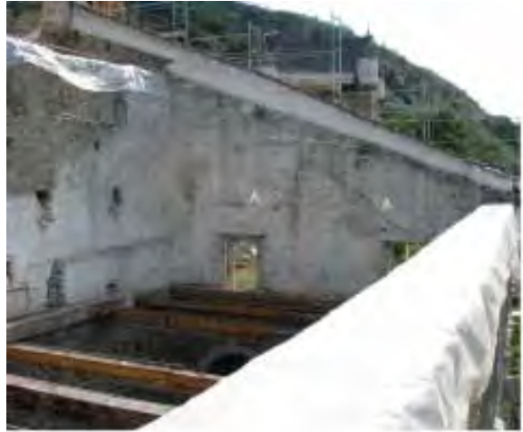
Abb.11 Palas-Ostmauer. Rechts unterhalb des Giebels erkennt man die im Mauerwerk eingebundene Steinplatten des ursprünglichen Satteldaches (A). Aufnahme 2006 nach Demontage der Dachkonstruktion.
