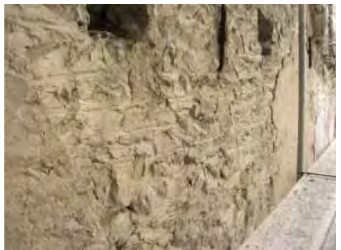
Abb.15 Palas-Nordfassade, Detail der Mauerfläche. Der rasa pietra Putz mit horizontalem Fugenstrich entstand beim Bau des Palas'.
