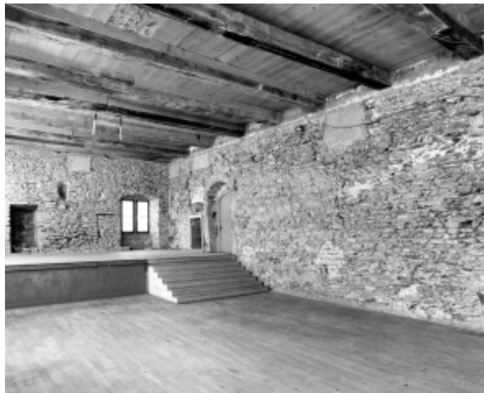
Abb.16 Palas-Nordwand, Theatersaal von 1952. Die Deckenhöhe schneidet die vermauerten Öffnungen des ehemaligen Obergeschosses. Die Bodenhöhe des Saal-Geschosses befand sich etwa auf halber Höhe zwischen der Bühnen- und der Zuschauerebene. Ansicht gegen Nordwesten.
