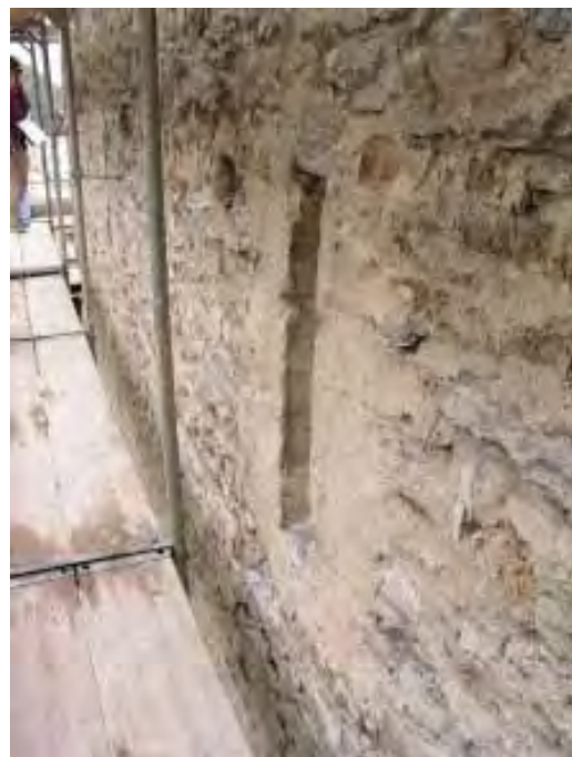
Abb.41 Palasannex, Nordfassade: Fenster des 2. Geschosses. Um die Fenster herum ist der Mauermörtel in der Art eines deckenden Verputzes abgestrichen und weist horizontale Linien (Fugenstrich) auf.
