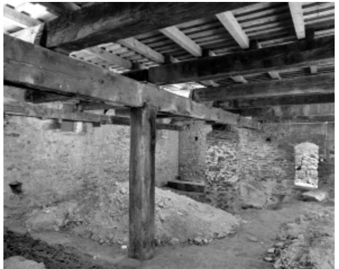
Abb.23 Palas, Keller. Aufnahme während der Sondierungsarbeiten von 2001. Hinter der hölzernen Stütze erkennt man die gemauerte Säule und im Hintergrund die Binnenmauer, die den Keller unterteilt. Ansicht gegen Westen.
