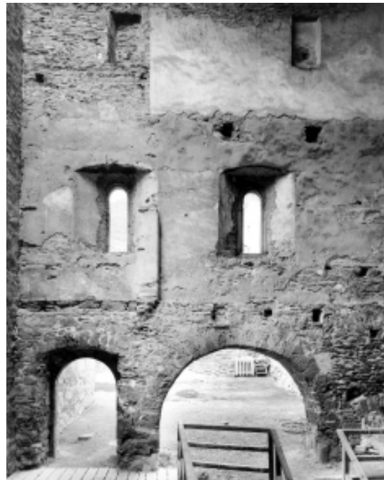
Abb.37 Palasannex, Nordwand. Balkenlöcher und Verputze lassen eine Gliederung in drei Geschosse erkennen. Zwischen dem Rundbogenportal und der Türe links bestand eine Binnenmauer, die in einer späteren Phase bis ins oberste Geschoss aufgemauert wurde.
