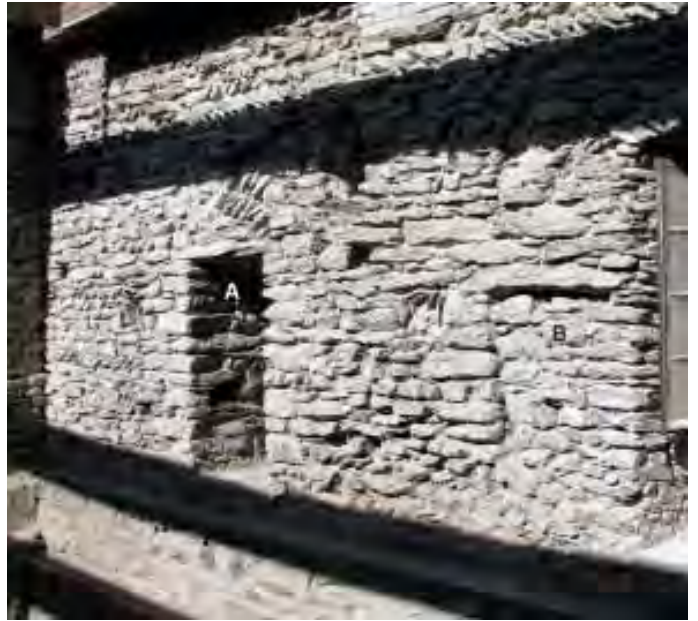
Abb.22 Palas-Westmauer, Saalgeschoss. Detail des originalen Mauerwerks mit der Latrinentüre (A) und einer vermauerten Schartenöffnung (B).
