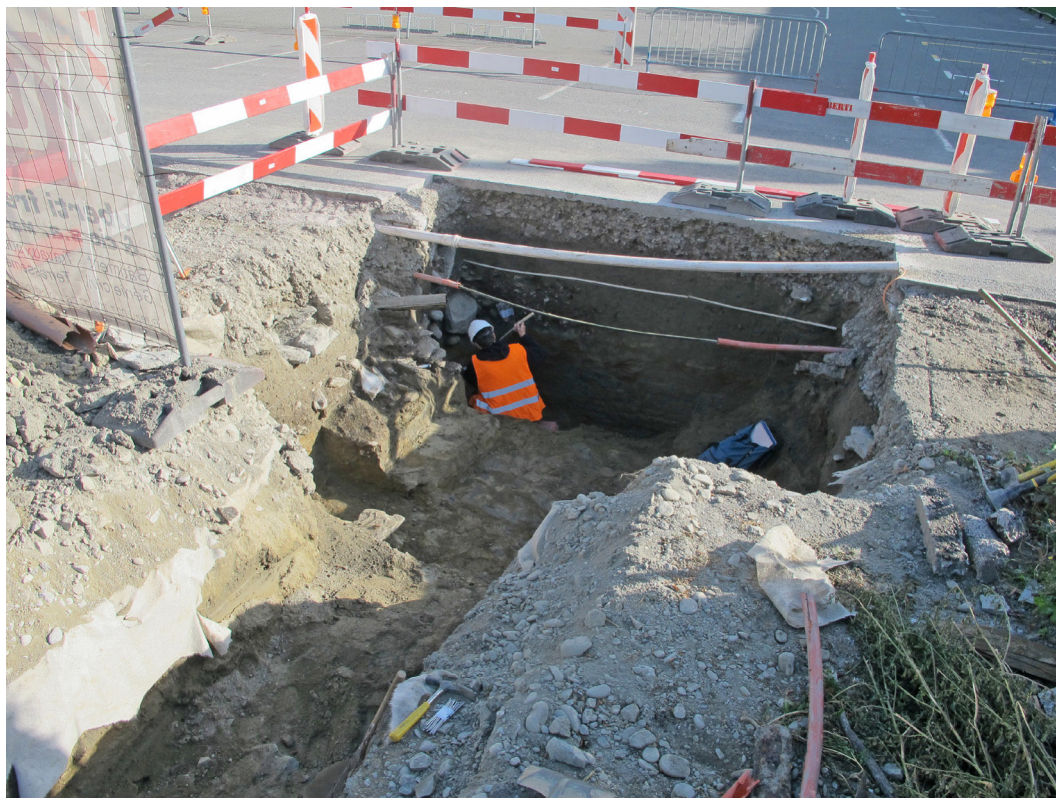
Fig. 2 – Martign, chantier Sinergy. Au premier plan, la maçonnerie liée au ciment M059. A l'arrière-plan, l'angle d'un bâtiment (murs M057 et M058). Vue en direction de l'ouest.
