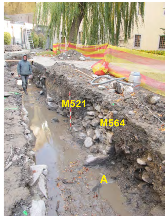
Fig. 12b. St-Maurice, cour St-Joseph. Tranchée, vue du sud-ouest. Le mur M564 marque la limite entre une zone construite au nord-est et un secteur dépourvu de bâtiments au sud-ouest- A: sommet arasé de la maçonnerie M567 recouvert d'eau boueuse.
