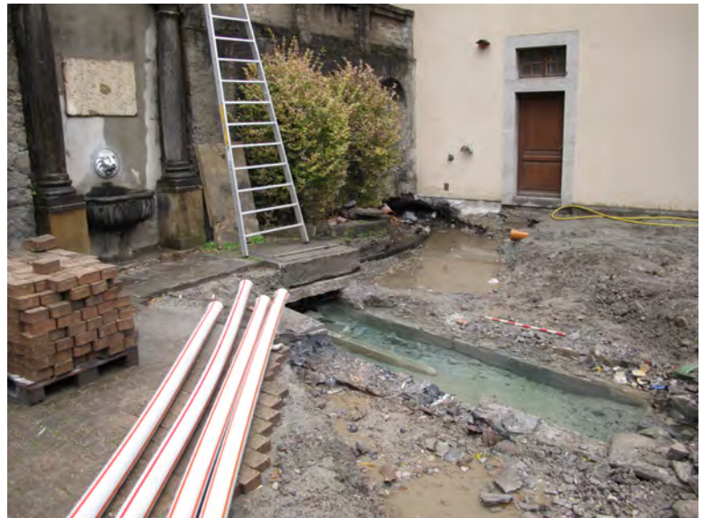
Fig. 1. St-Maurice, Cour St-Joseph. Le bassin de la source en pierre taillée, après démolition de la partie supérieure en ciment. Vue du sud-ouest. On constate que l'eau boueuse qui se trouve de part et d'autre ne contamine pas l'eau du bassin.
