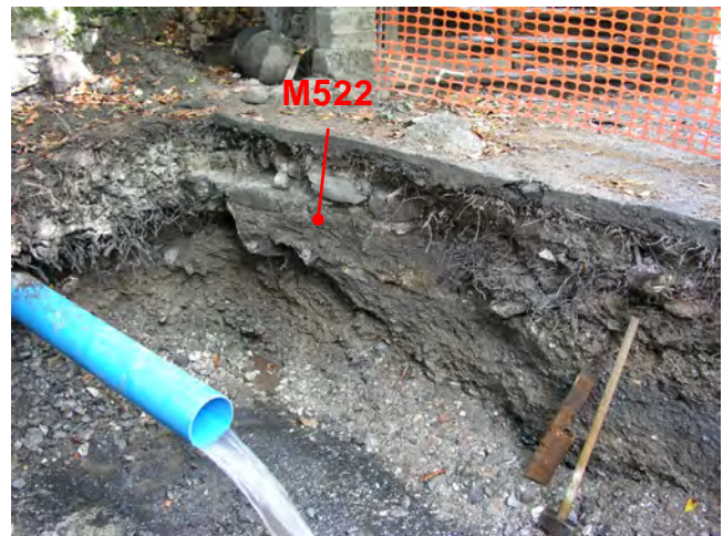
Fig. 21. St-Maurice, cour St-Joseph. Excavation 2003, profil nord-est, vu du sud. Le parement sud du mur M522 avait été observé en 2003. Son orientation n'avait pas pu être exactement déterminée.
