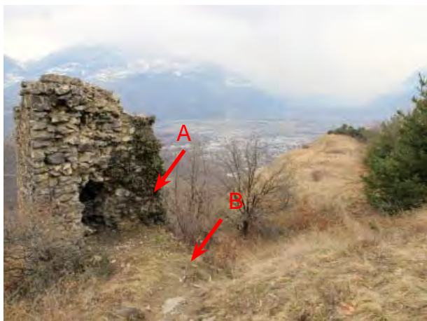
Fig. 34. Château, la tour d'angle (No 11) à la jonction des courtines sud et ouest. Vue en direction du sud-ouest. A: Le parement manque; la maçonnerie arrachée doit être consolidée. Le lierre ronge le mortier. B: Des vestiges de la courtine ouest et d'une éventuelle poterne (petite porte secondaire) pourraient être conservés sous la végétation.
