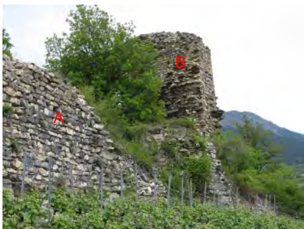
Fig. 18. Bourg, courtine sud (No 3). Effondrement des maçonneries à la jonction de la courtine sud (A) et du mur-bouclier (B).
