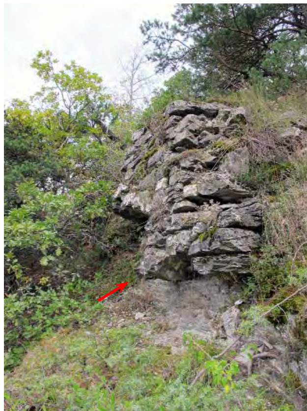
Fig. 27. Château, courtine nord (No 8). Quelques tronçons discontinus de la mureille sont encore visibles. Ils risquent de s'effondrer si leur base n'est pas consolidée.
