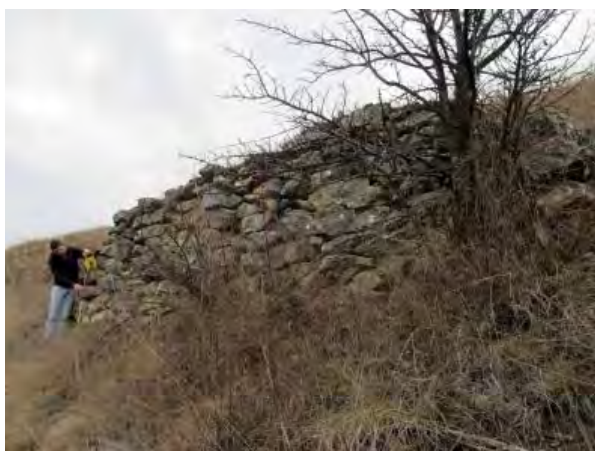
Fig. 38. Jardins, mur de terrasse (No 13). Vue en direction du nord-ouest. Maçonnerie en pierres sèches.
