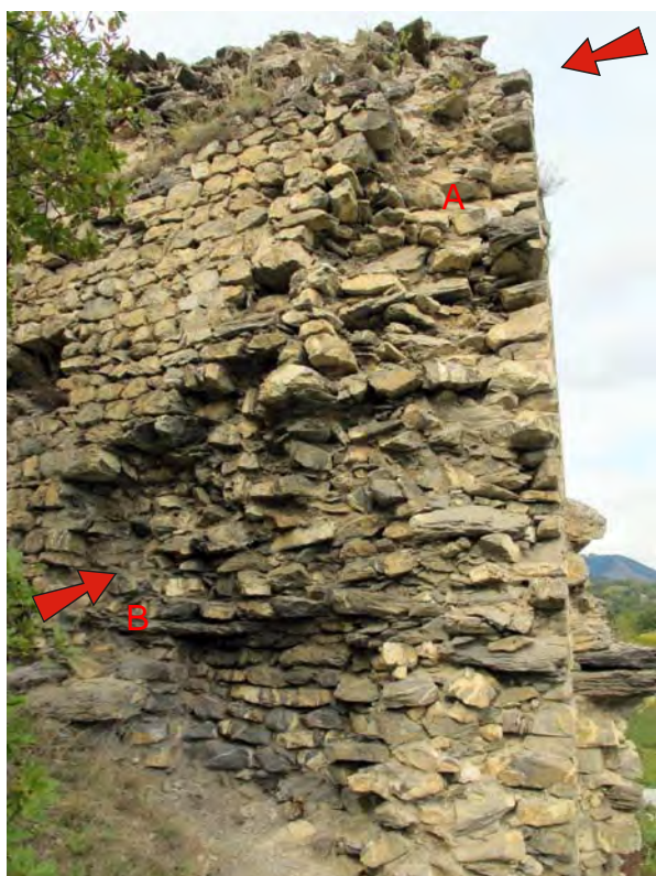
Fig. 14. Bourg, angle sud du mur-bouclier (No 2). Vue vers l'est. A: Zone d'arrachement de la courtine sud. B: La lacune du parement doit être consolidée (risque d'effondrement du parement supérieur).
