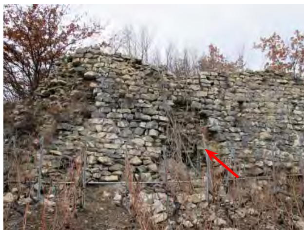
Fig. 19. Bourg, courtine sud (No 3). Détail d'une partie de maçonnerie particulièrement instable.
