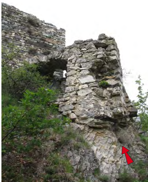
Fig. 05. Bourg, porte avancée est (No 1). Les fondations du piédroit nord sont déchaussées en sape. La maçonnerie menace de s'effondrer.
