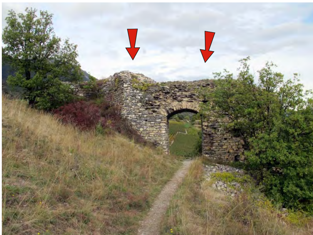
Fig. 13. Bourg, mur-bouclier avec porte (No 2). Vue de la face intérieure. Sur l'arasement défectueux la végétation se développe.
