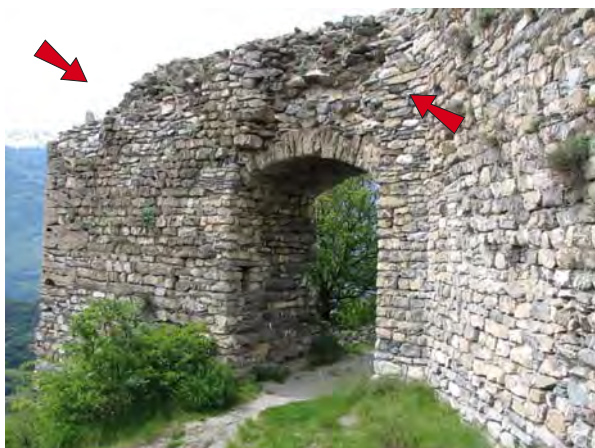
Fig. 11. Bourg, mur-bouclier avec porte (No 2). Les pierres du parement menacent de tomber sur les personnes accédant au site.
