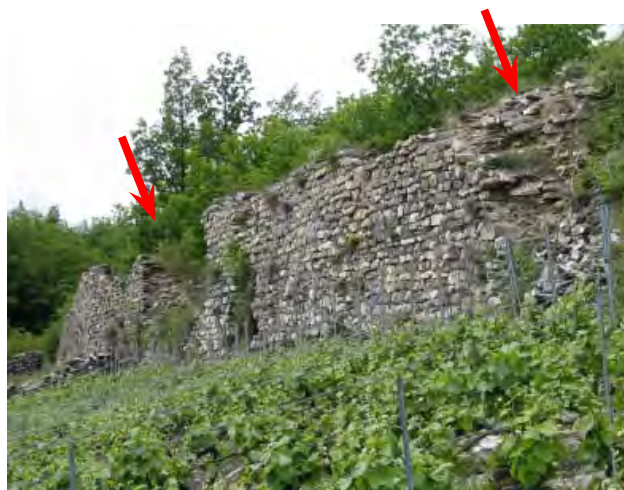
Fig. 17. Bourg, courtine sud (No 3). Des pans de murs entiers menacent de s'effondrer.
