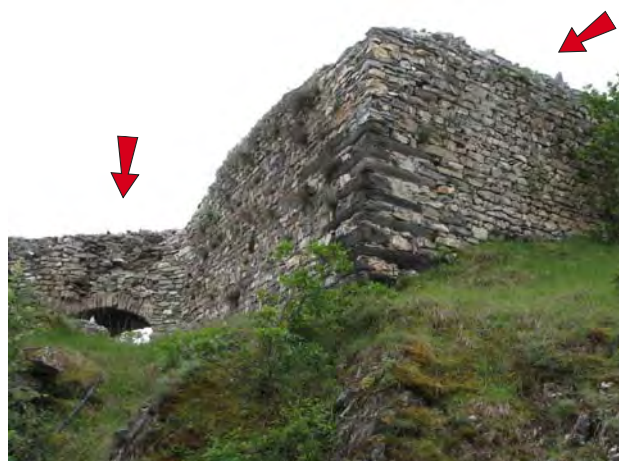
Fig. 10. Bourg, mur-bouclier avec porte (No 2). Au-dessus de la porte, les pierres du parement sont dé-garnies et risquent de tomber. Au niveau de l'arasement du mur, le scellement au mortier est à compléter.
