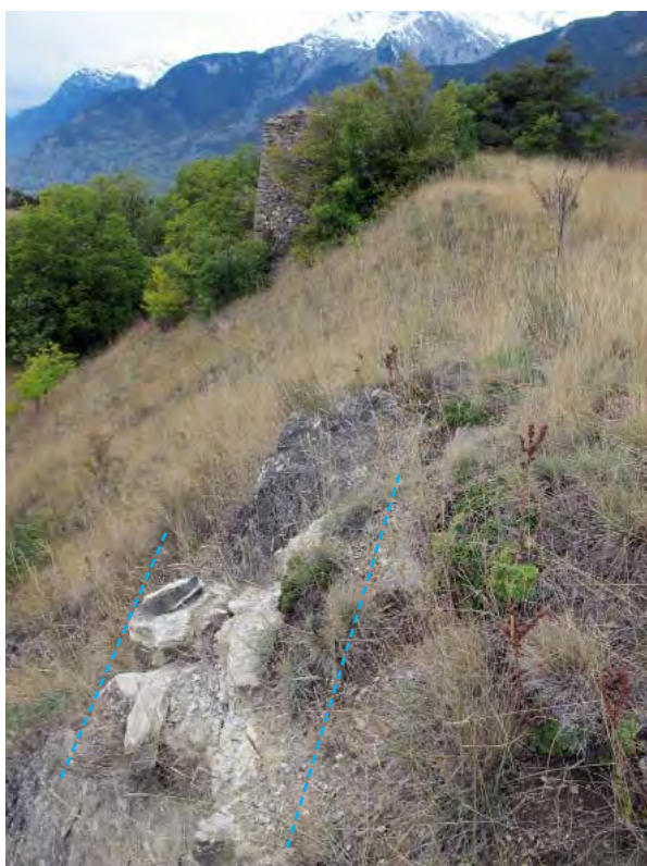
Fig. 28. Château, courtine sud (No 9). Vue en direction de l'ouest. Les maçonneries sont très arasées et en grande partie recouvertes de végétation. Les tronçons visibles doivent être consolidés (risque d'effondrement sur le chemin en contrebas).
