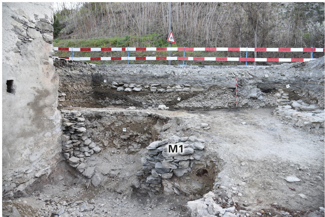
Fig.1b – Granges, Fauporte. Vue générale de la fouille. Au premier plan, le mur de soutènement de la rue, effondré (M1). Vue du sud.
