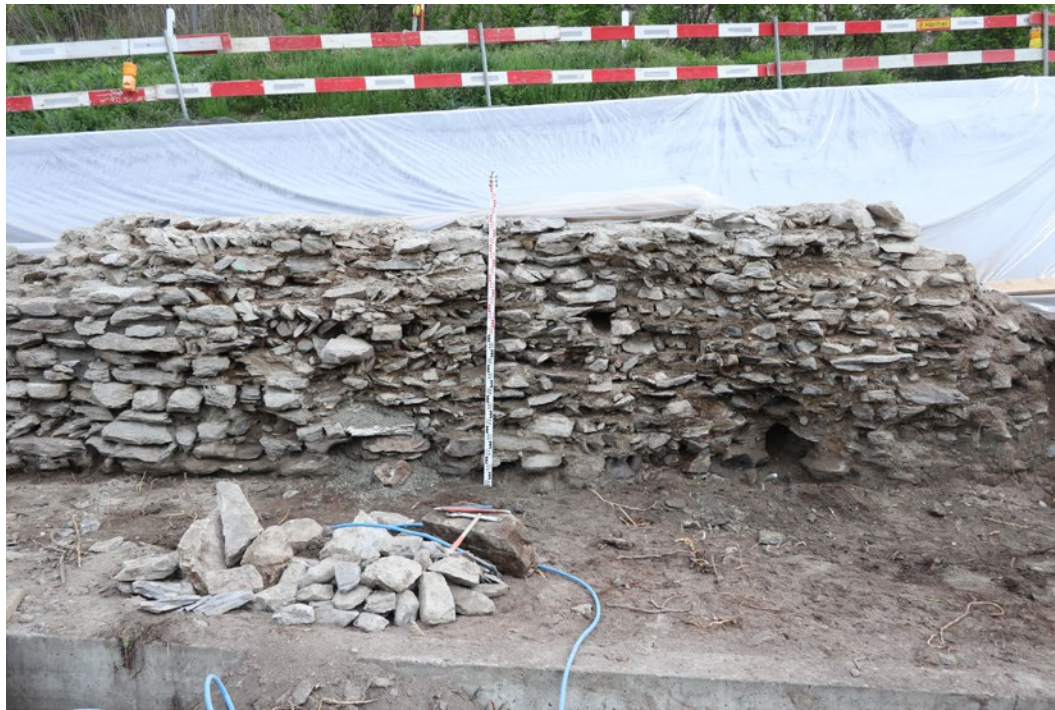
Fig. 19 – Granges. Rue des Remparts. Le parement extérieur du mur a été arraché. Le blocage est visible, constitué de petites pierres irrégulières arrangées de sorte à respecter les assises des parements. Vue du sud-ouest.
