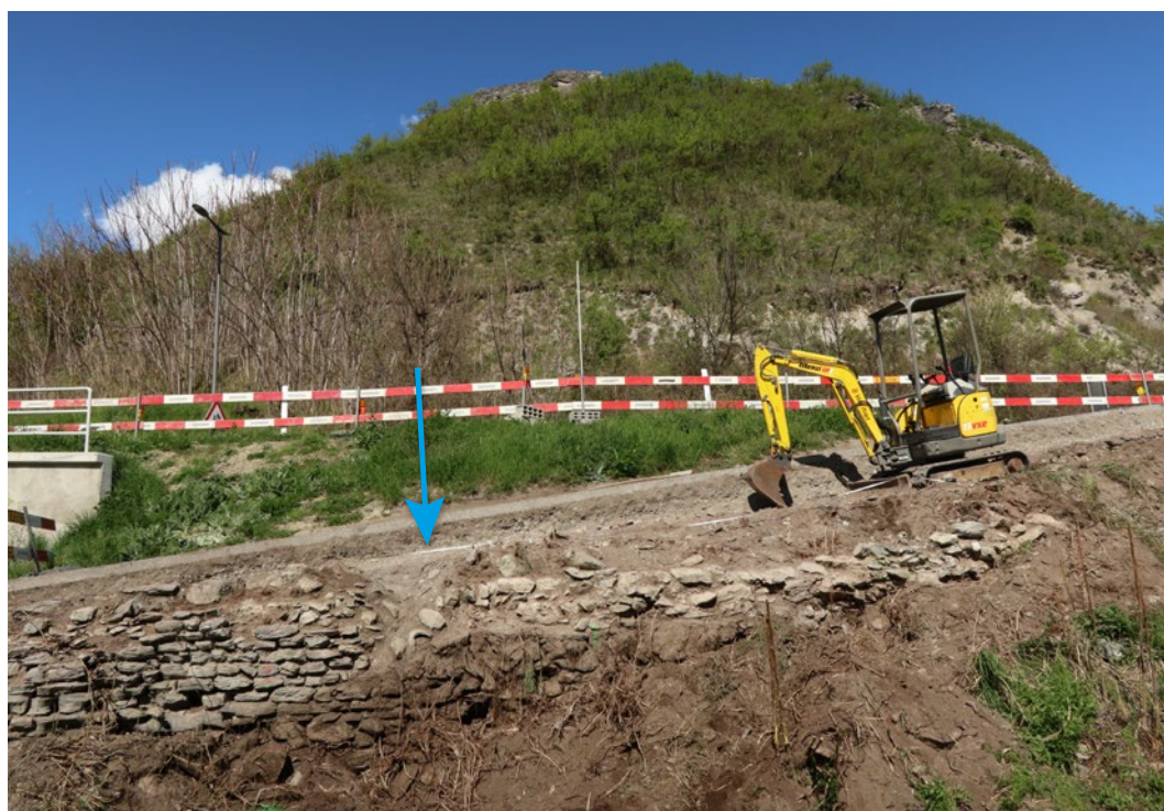
Fig. 21 – Granges. Rue des Remparts. Le passage d'une conduite d'eau claire aujourd'hui désaffectée (flèche) a nécessité la démolition du sommet conservé de l'enceinte. Vue du sud-ouest.
