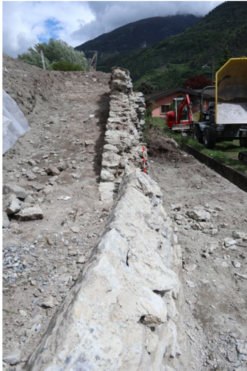
Fig. 9 – Granges. Rue des Remparts. Partie écroulée de l'enceinte. Vue du nord-ouest.
