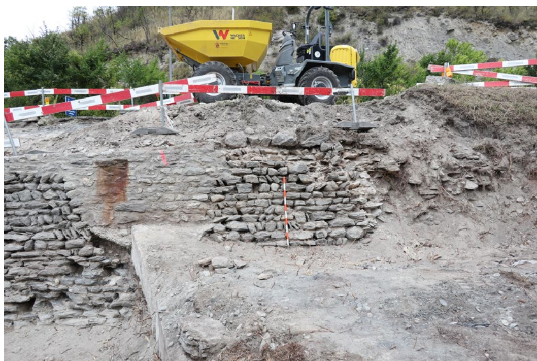
Fig. 22 – Granges. Rue des Remparts. Une conduite électrique récente a engendré la démolition du mur sur une bonne partie de sa hauteur, et sa reconstruction. Vue du sud-ouest.
