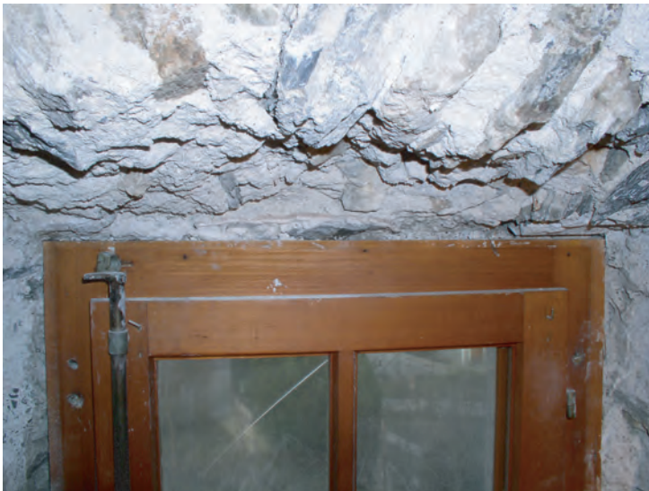
fig.47 Annexe (C), local C2; fenêtre (15), au-dessus du cadre en bois, on devine le stuc de l'ancienne embrasure plus étroite.
