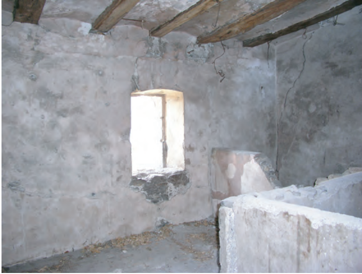
fig.21 Annexe (A); les cuves (28).
