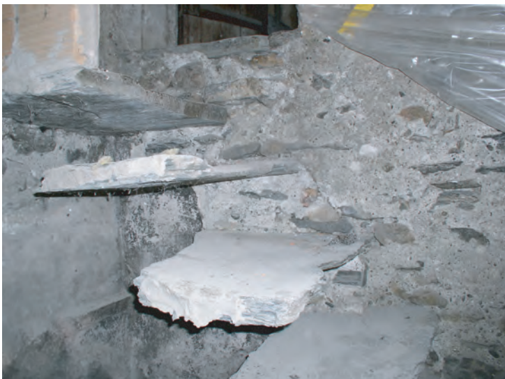
fig. 13 Façade Sud de la cage d'escalier (B); haut de l'escalier (35b). Les dalles des marches percent la maçonnerie.
