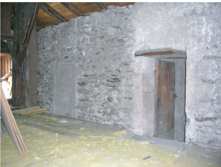
fig. 10 Combles (E); à droite, la porte (29) dont le linteau a été rehaussé. A gauche, la porte bouchée (22).
