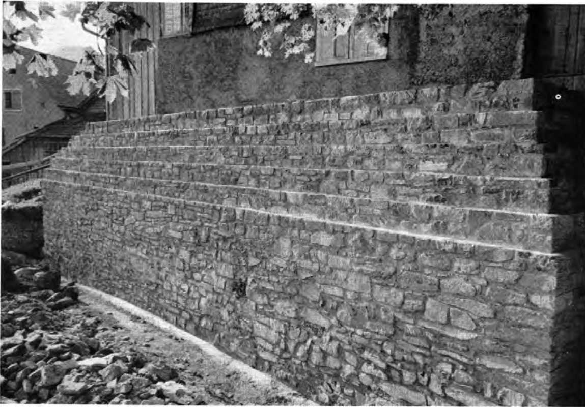
Tafel 31 A. Filzbach GL, Voremwald. Die Nordmauer des Turmes nach der Wiederherstellung.
