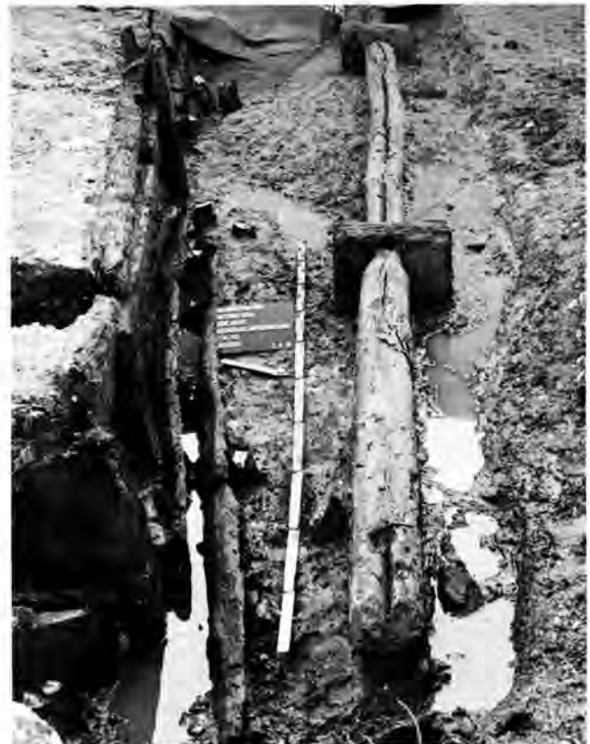
Abb. 52. Winterthur, Oberwinterthur ZH, Unteres Bühl. Deuchelleitung mit Holzmuffen und zusammengedrückter Kanal aus dem Anfang des 1. Jahrhunderts.
