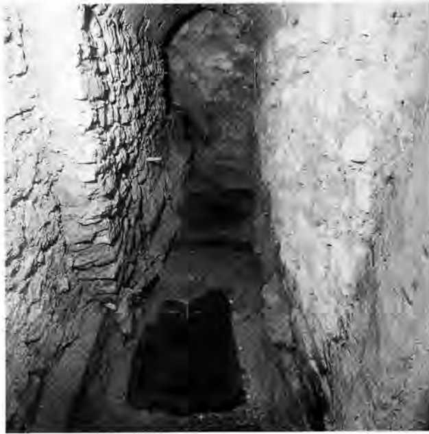
Abb. 38. Studen BE, Rebenweg/Petinesca. Blick in den heutigen Quellstollen. Das Holzbecken im Vordergrund diente im 2. Jh. als Sandabscheider. Foto ADB.
