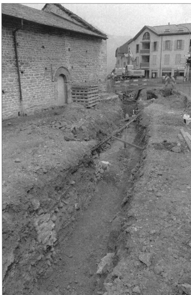
Fig. 3 – Chamoson, Saint-Pierre-de-Clages. Le chantier, vu du nord. A gauche, la façade nord de l'église. Des structures romaines, murs et sols en mortier, apparaissent dans la tranchée.
