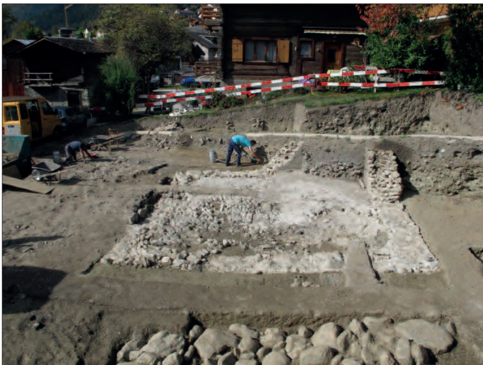
Fig. 4. Bagnes, Villette. Bâtiment quadrangulaire Bat1. L'édifice a été détruit au niveau du sol lors de l'excavation à la pelleuse. Seul l'angle nord du bâtiment est conservé sous la conduite d'égout. Vue depuis le sud-est. (Photo: TERA, Sion)
