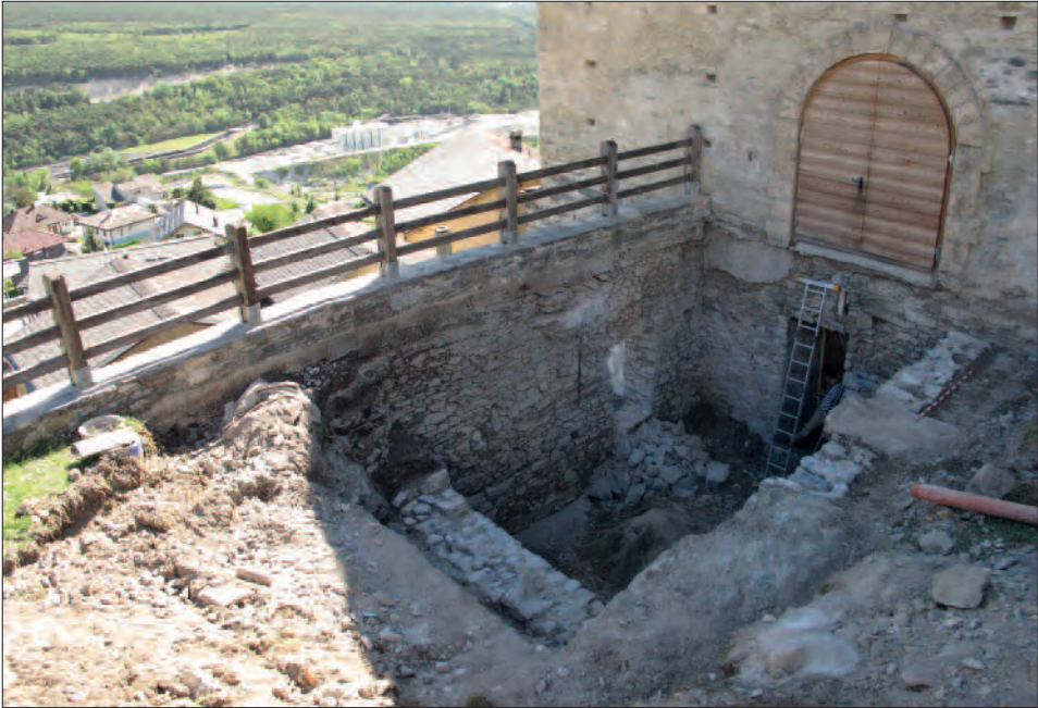
Fig. 6. Loèche-Ville, Turmmatte. Petit bâtiment attenant à la façade orientale du palais du Bischofsschloss . Vue depuis le nord-est. (Photo: TERA, Sion)
