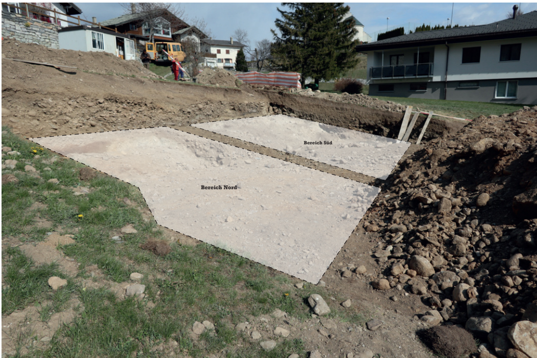
Abb.3 – Guttet-Feschel, Wiler. Blick von Nordwesten auf die Grabungsfläche mit dem nördlichen und südlichen Bereich.
