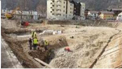
Abb. 1: Ansicht der Grabungsfläche nach den Baggerarbeiten; die ersten archäologischen Schichten kommen zum Vorschein. © InSitu Archéologie SA/OCA
