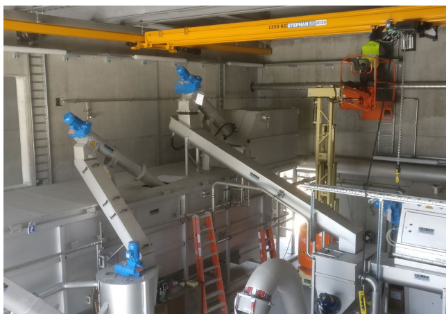
FIGURE 11 - STEP DE COLLOMBEY-MURAZ – NOUVEAU BÂTIMENT DE PRÉTRAITEMENT
