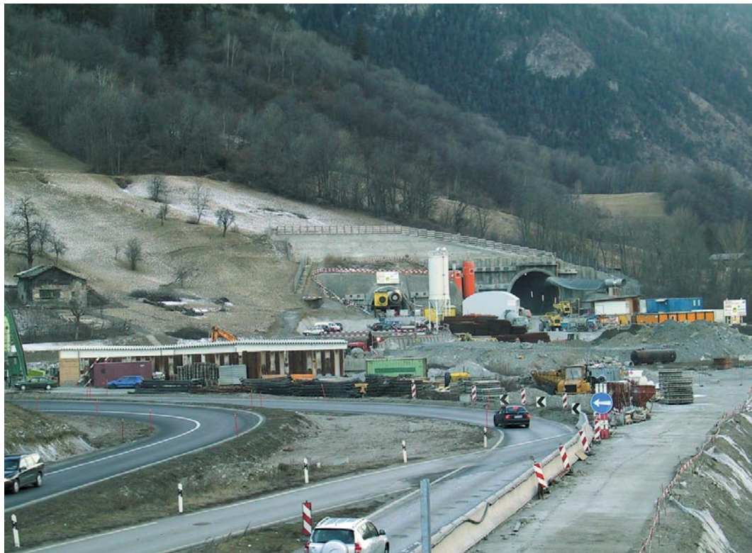
Grosshüs: Ostportal der Tunnels für die Südumfahrung von Visp. Die Hälfte der Autobahn im Oberwallis – d.h. fast 17 Kilometer – wird unterirdisch geführt.
