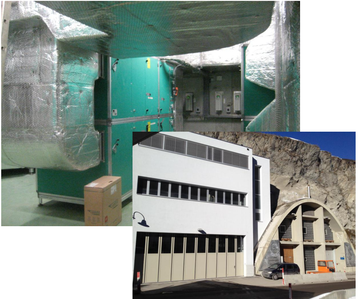
Abb. 19 : Lüftungszentrale – ARA Zermatt
