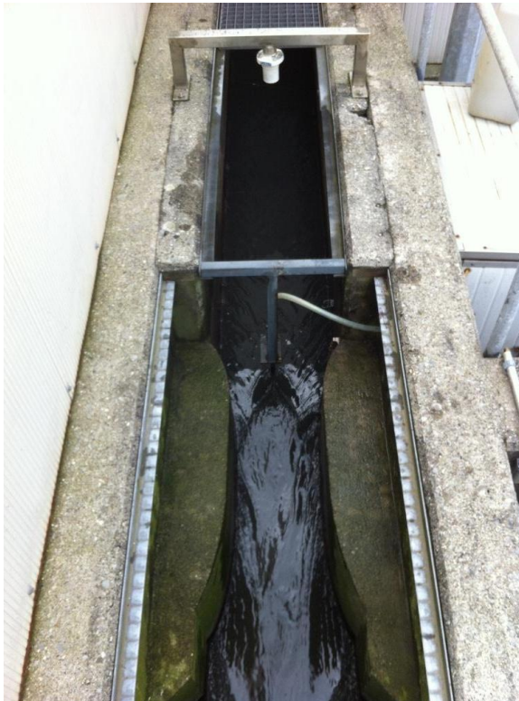
Abb. 8 : Venturi Durchflussmessung Zulauf ARA Collombey-Muraz
