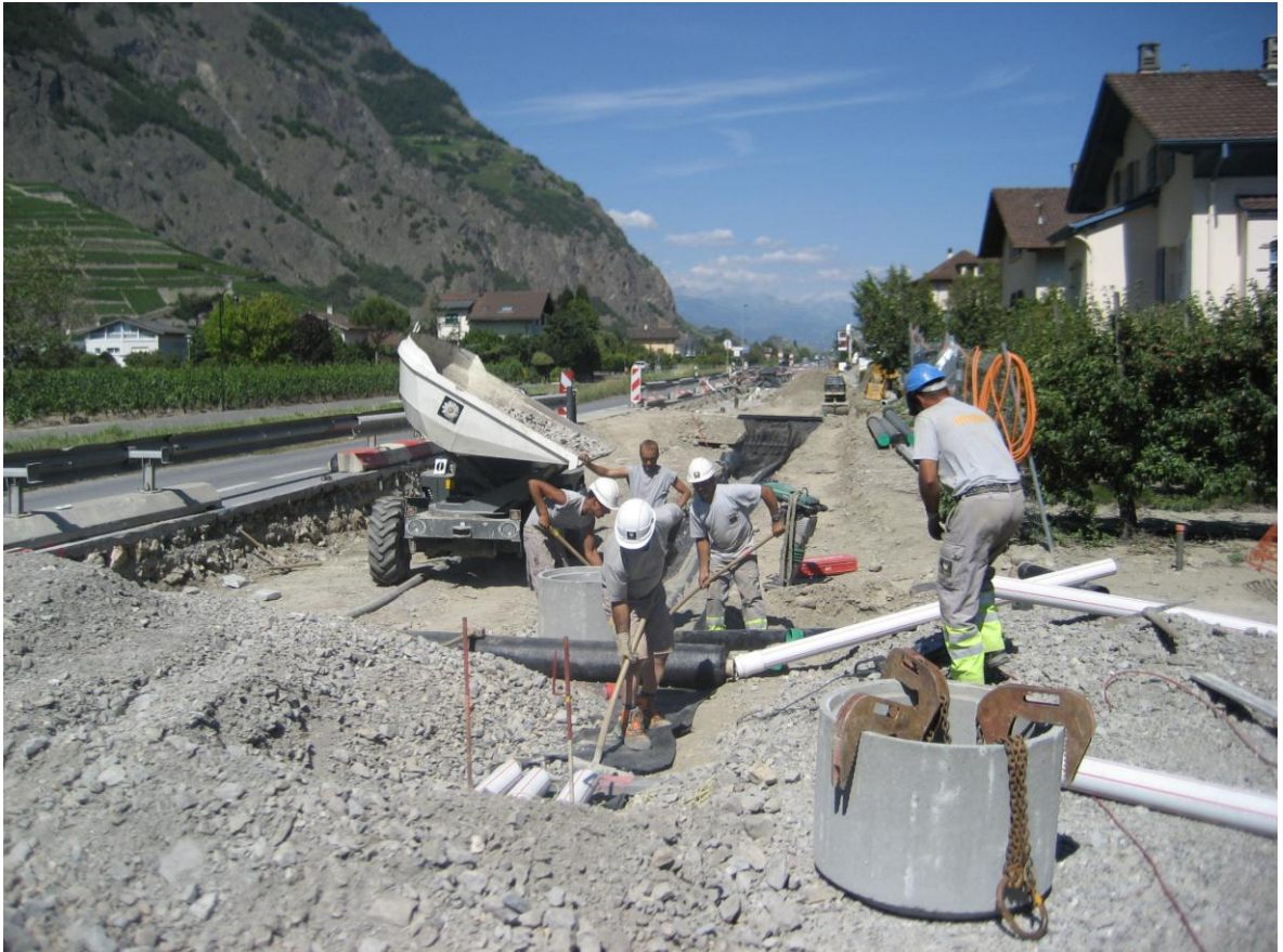
Abb. 12 : Gemeinde Fully: Sammelleitung auf der linken Kanalseite
