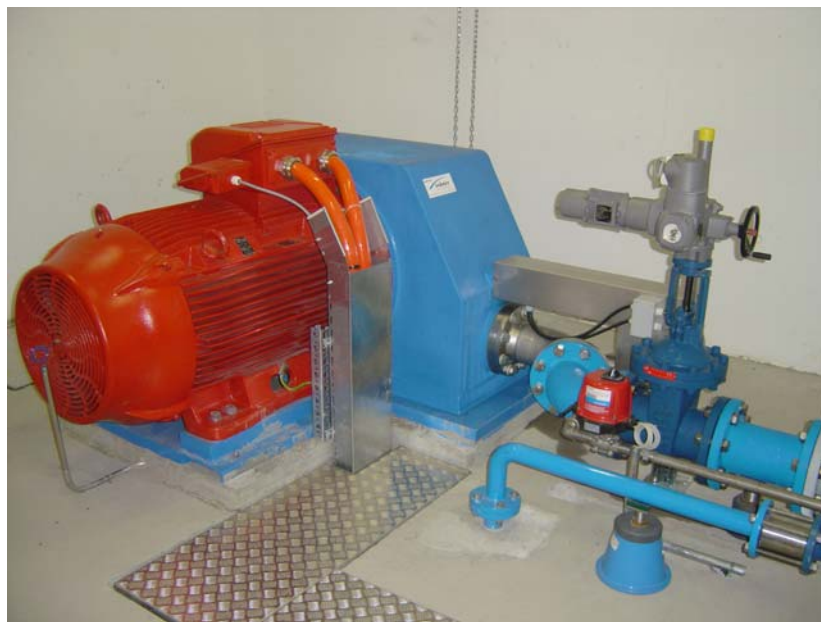
Abb. 19 : ARA Grächen – Turbine für gereinigtes Abwasser (80 l/s)
