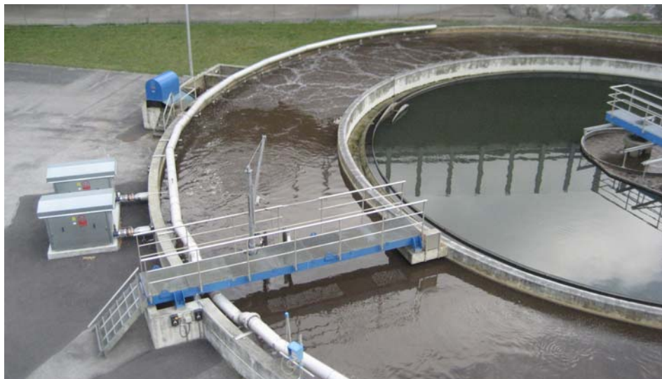
Abb. 5 : Ausbau der ARA Evionnaz und Umgebung (9'000 EW, mit Nitrifikation)
