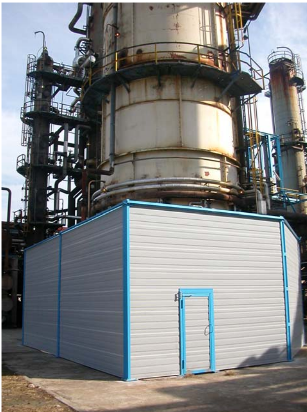
Fig. 14 : Mur anti-bruit autour du four 1102
