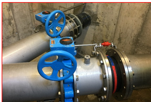
13 : Installation de distribution de l'eau. © SCAV
