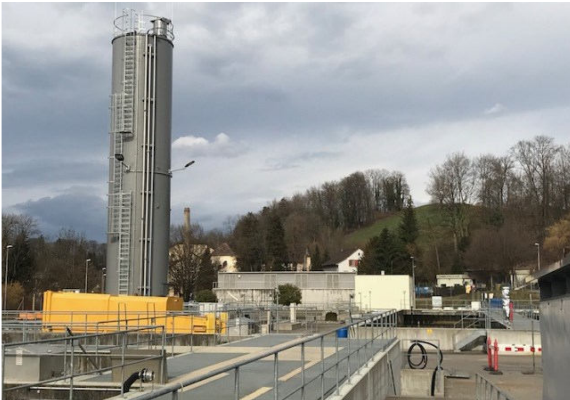
Abb. 20 Beispiel ARA Wetzikon (37'500 EW) mit Direktdosierung von Pulveraktivkohle (PAK) in die Biologie; links das PAK-Lagersilo (100 m 3 )
