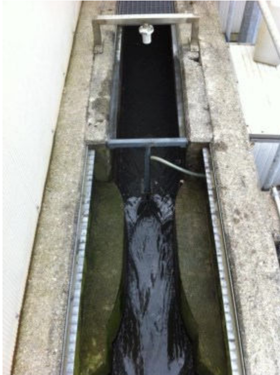
Abb. 6 : Venturi Durchflussmessung Zulauf ARA Collombey-Muraz
