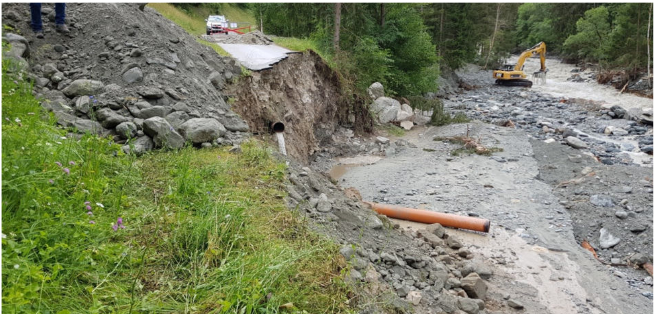
Abb. 4 : Val d'Anniviers – Schäden durch die Überschwemmungen der Navisence am 2. Juli 2018
