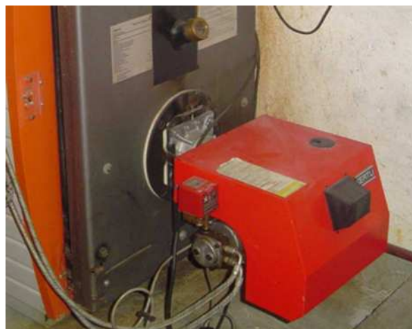
Abb. 27: Die Heizungen verursachen 24% der Kohlenmonoxid-Emissionen
