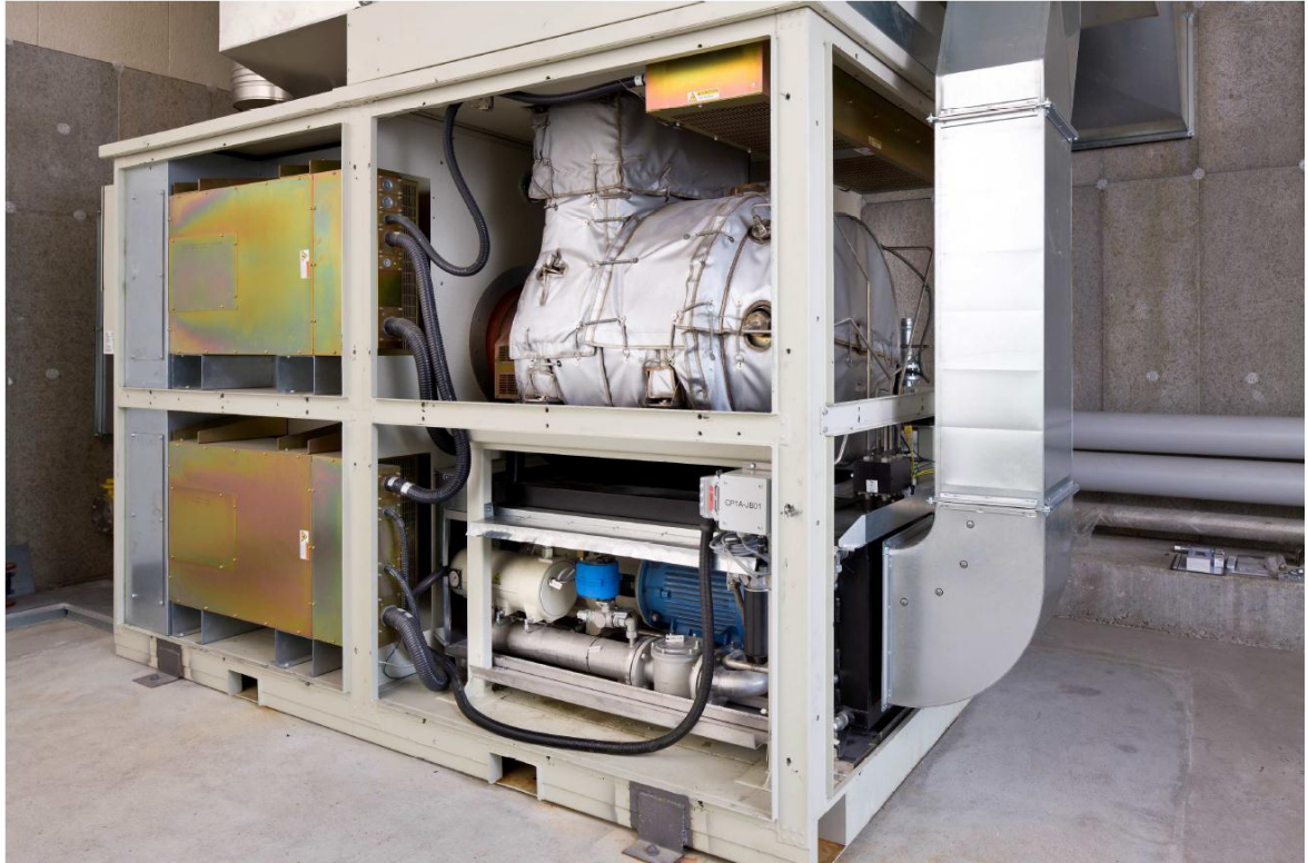
Figure 16 Turbine CCF de Sierre-Noës : du courant vert pour 250 ménages (Photo Sierre-Energie)
