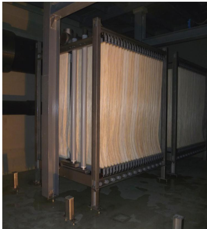
Figure 6 : STEP Zermatt, modules avec membranes
