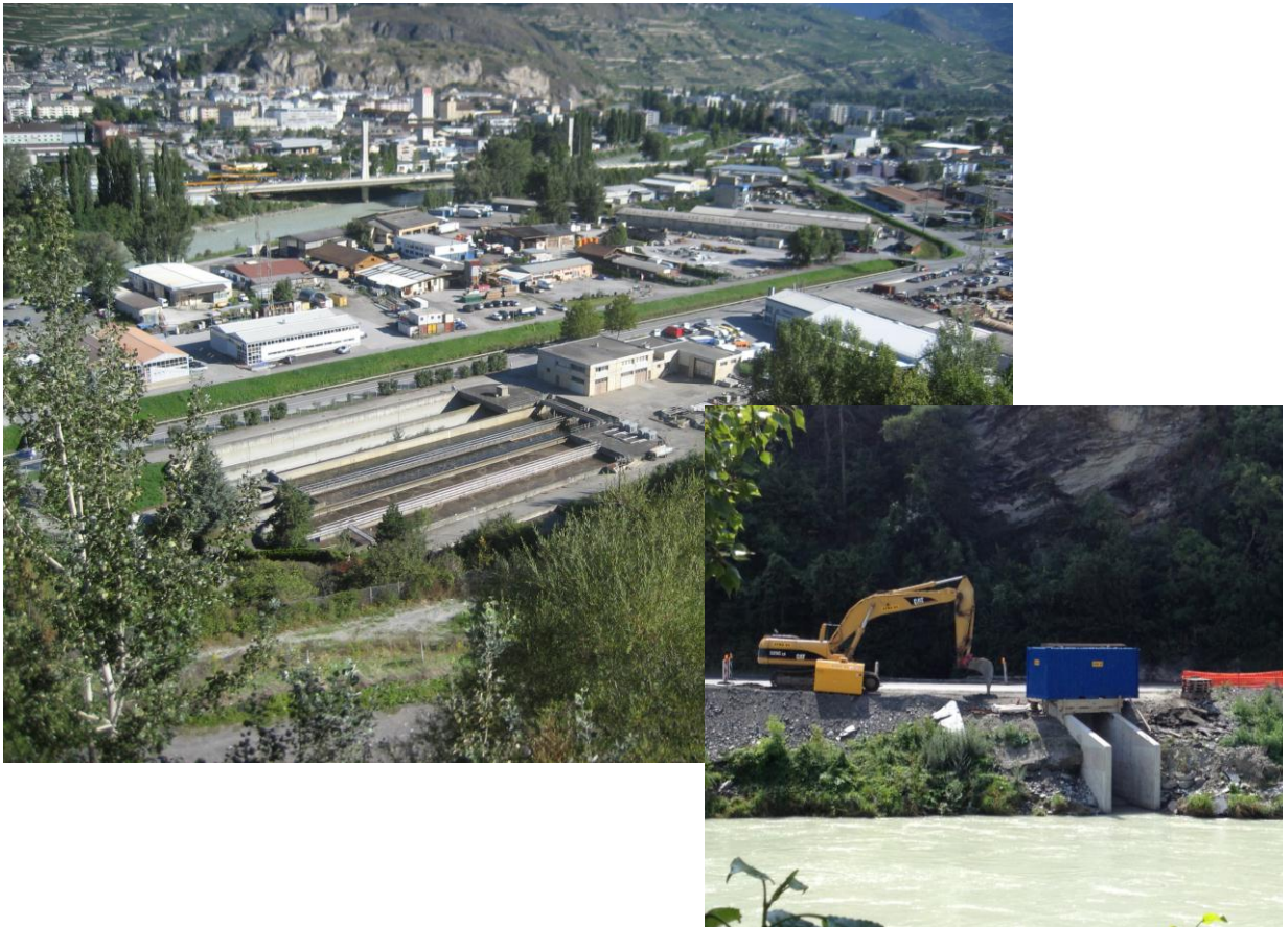
Figure 18 : STEP Sion-Chandoline – nouvel exutoire au Rhône qui permettra d'améliorer la qualité du canal Vissigen
