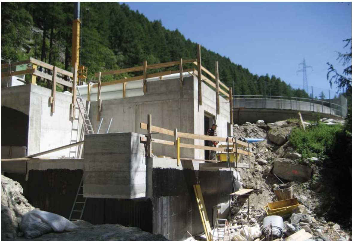
Abb. 12: ARA Saastal: Pumpwerk des geklärten Abwasser in die Leitung des Wasserkraftwerkes Ackersand I AG, zur Verbesserung der Wasserqualität der Saaser Vispa.
