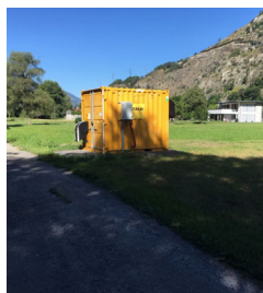
Installation pilote de biosparging zg Lonza
